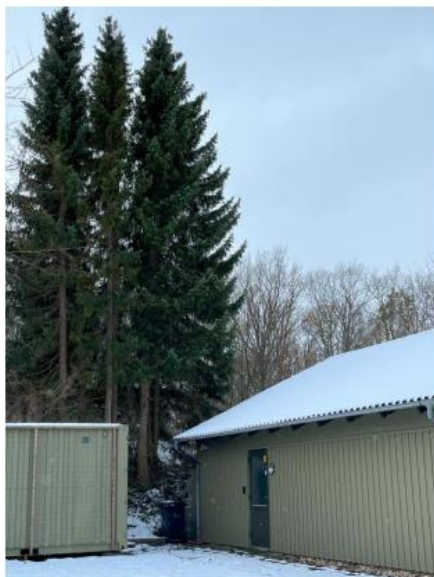
5 solitære nåletræer nær klubhuset er vurderet til at udgøre en risiko fremadrettet. Denne risiko bremser ønsket om en energimæssig tagrenovering og evt. opsætning af solceller.
