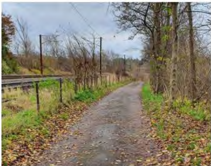
Vejen er i dag med asfalt af ældre dato og er meget ujævn og hullet.
