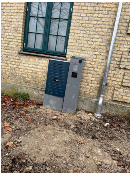
Eksempel på måleskab (den grå) og ledningsskab (den grønne).
