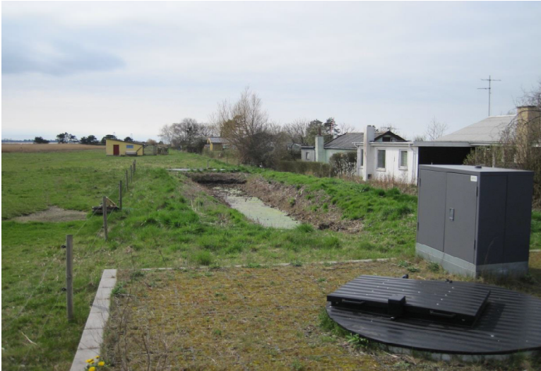
Figur 2.6: Pumpestation og regnvandsbassin ved Bildsøvej
