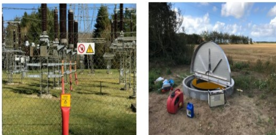
Figur 2-16 Eksempelfoto af markeringspæl og linkboksbrønd
