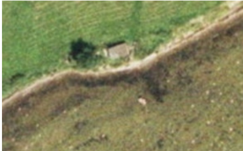
Luftfoto 2002 – tagplader i tagets syd-vest hjørne synes at mangle
